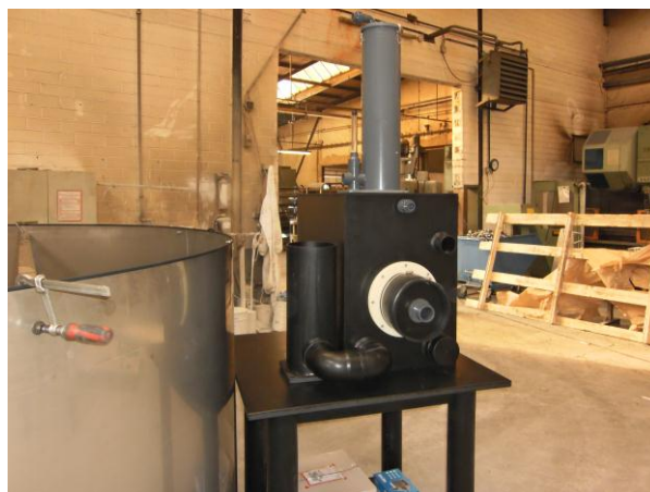
Trommelfilter, Pumpensumpf und Abschäumer
