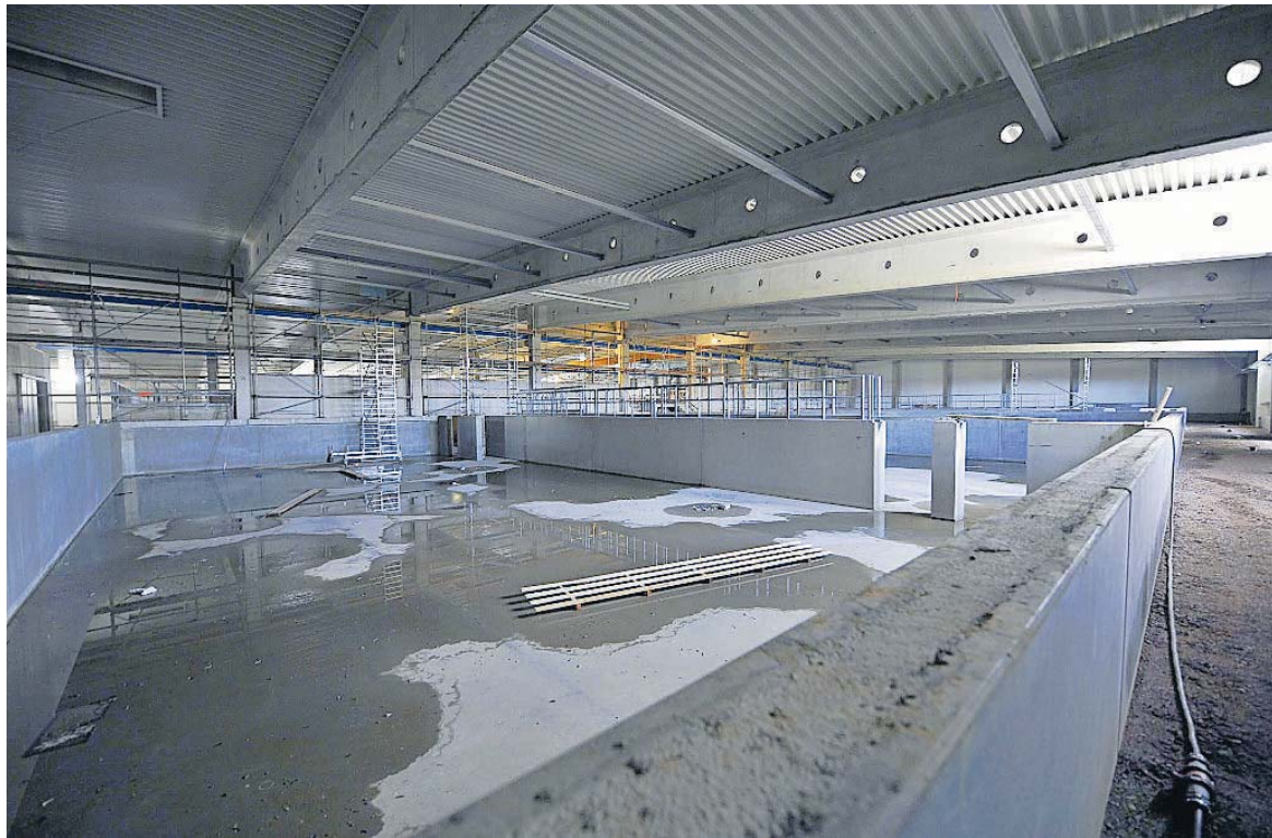
Demnächst sollen die Fahrwege in der rund 7000 Quadratmeter großen Produktionshalle betoniert werden. Anschließend sollen die technischen Anlagen eingebaut werden. Foto: Becker & Bredel
