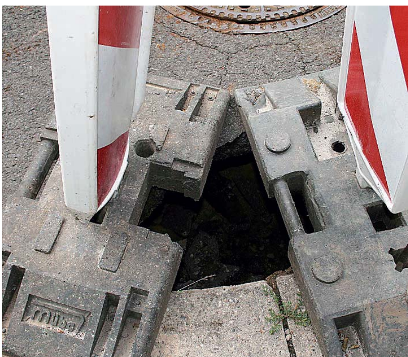
Ludweiler Loch: In der Kirchstraße ist die Straßendecke eingebrochen. Die Schadstelle, die etwa 50 Zentimeter Durchmesser hat, wurde vom städtischen Tiefbauamt provisorisch gesichert. Foto: Lange
