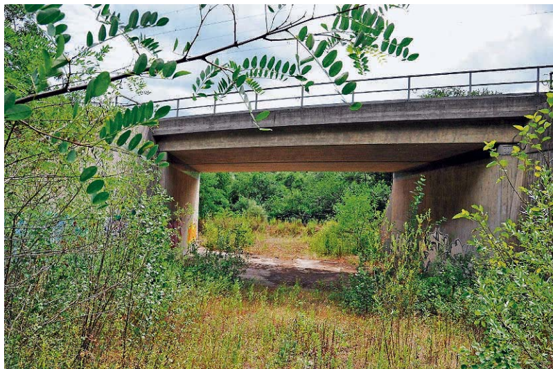
Über diese Eisenbahnbrücke schütteln die Prüfer im Rechnungshof nur den Kopf: Sie überbrückt überhaupt keine Straße. FOTO: BECKER&BREDER
